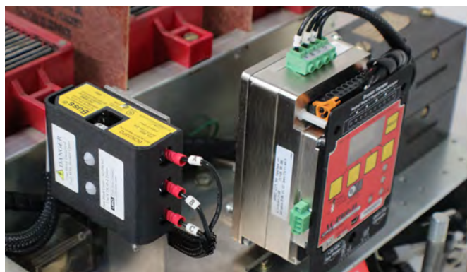
O relé de proteção AC-PRO-II® com Módulo de Monitoramento de Tensão e bloco de fusíveis com tampa no disjuntor DS
