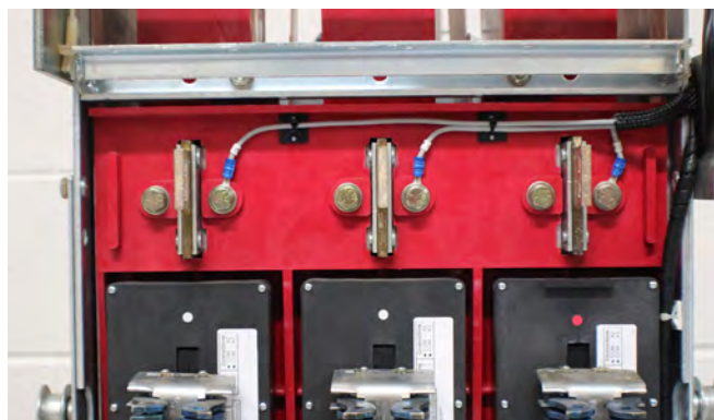
Conexões de tensão ao lado da linha no disjuntor DS (conectores de cobre removidos)
